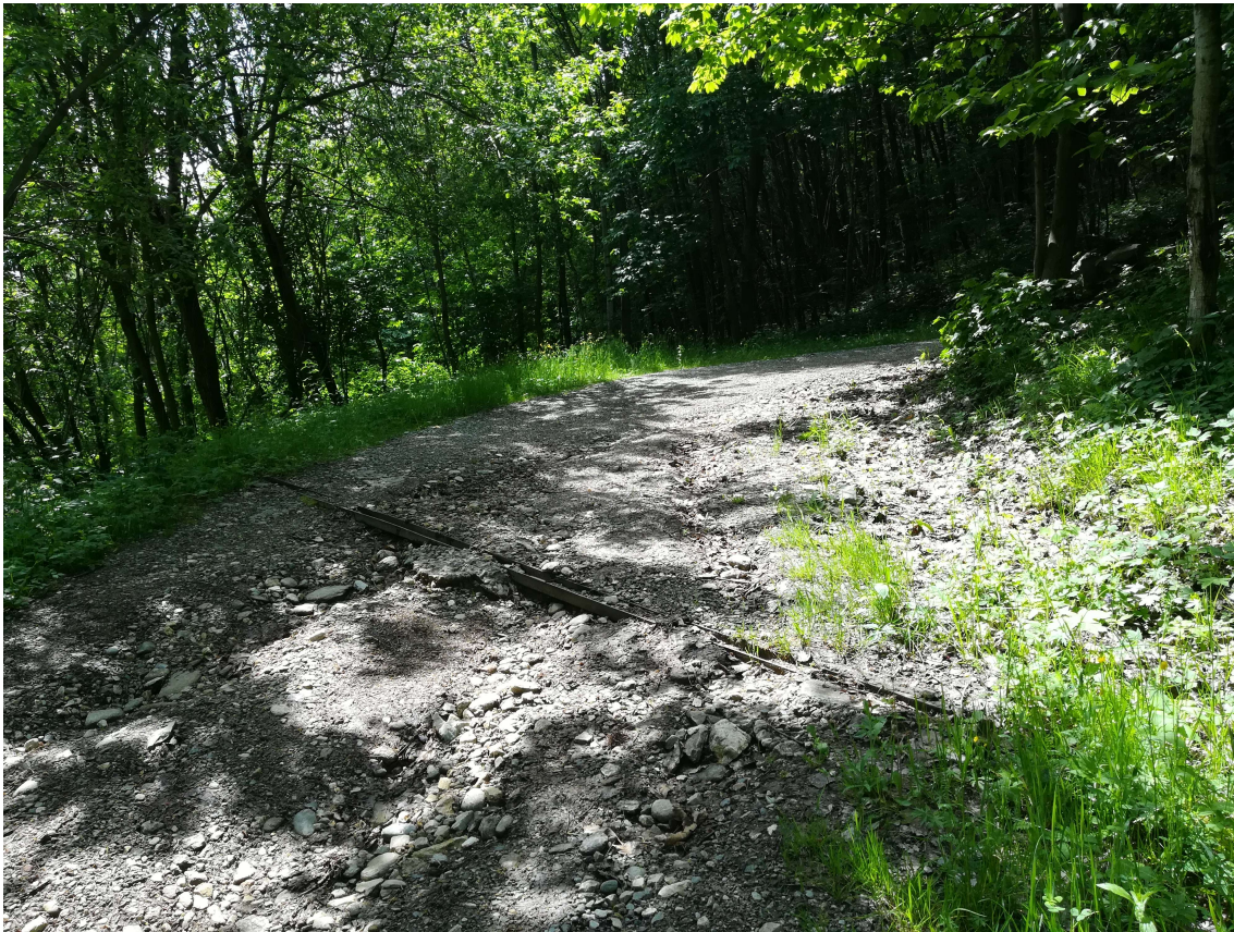
Foto 5: Vista su strada comunale, verso Borgata Garzini. Canaletta di attraversamento scalzata dalle acque di ruscellamento superficiale
